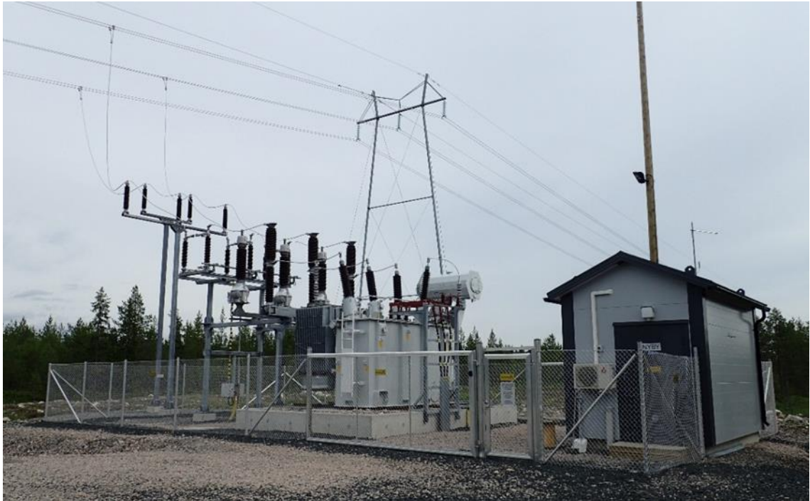
Kuva 77. Esimerkki tuulivoimapaiston pienehköstä noin 30 MW sähköasemasta.
