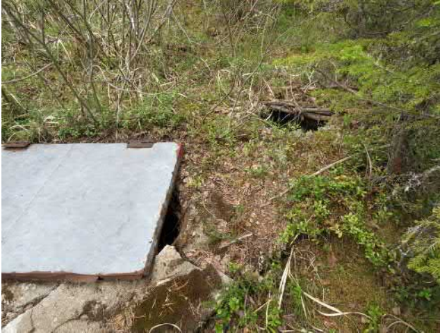
Kaivo (vain hatarasti peitetty &gt; vaarakohde)
